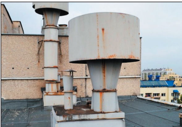
Stan techniczny elementów wentylacji przed wymianą...
