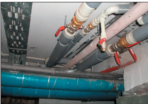
Stan instalacji wodnej w zasobach SM Piast po wymianie.
